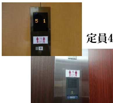
エレベーターホール エレベーター内
